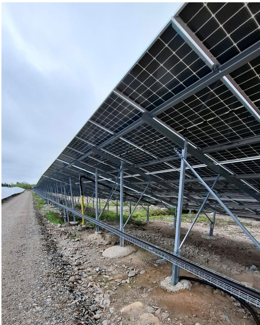
Kuva 4-3. Esimerkinomainen kuva aurinkopaneeleista ja niiden välisestä huoltotiestä aurinkovoimalassa. (© AFRY Finland Oy)
