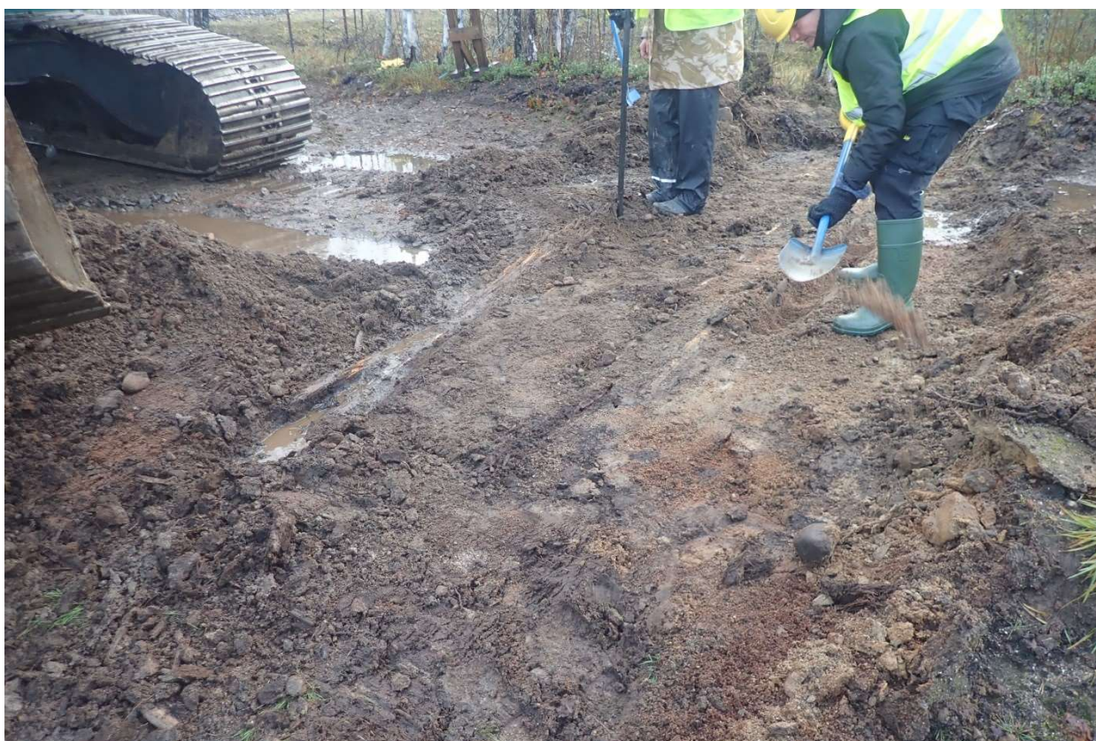
Kuva 3. Koeojan 2 ylimpien puiden pinnat ovat tulleet esiin tien pintakerrosten alta. Sampo Sääksvuori lapioi soraa puiden lomasta.
