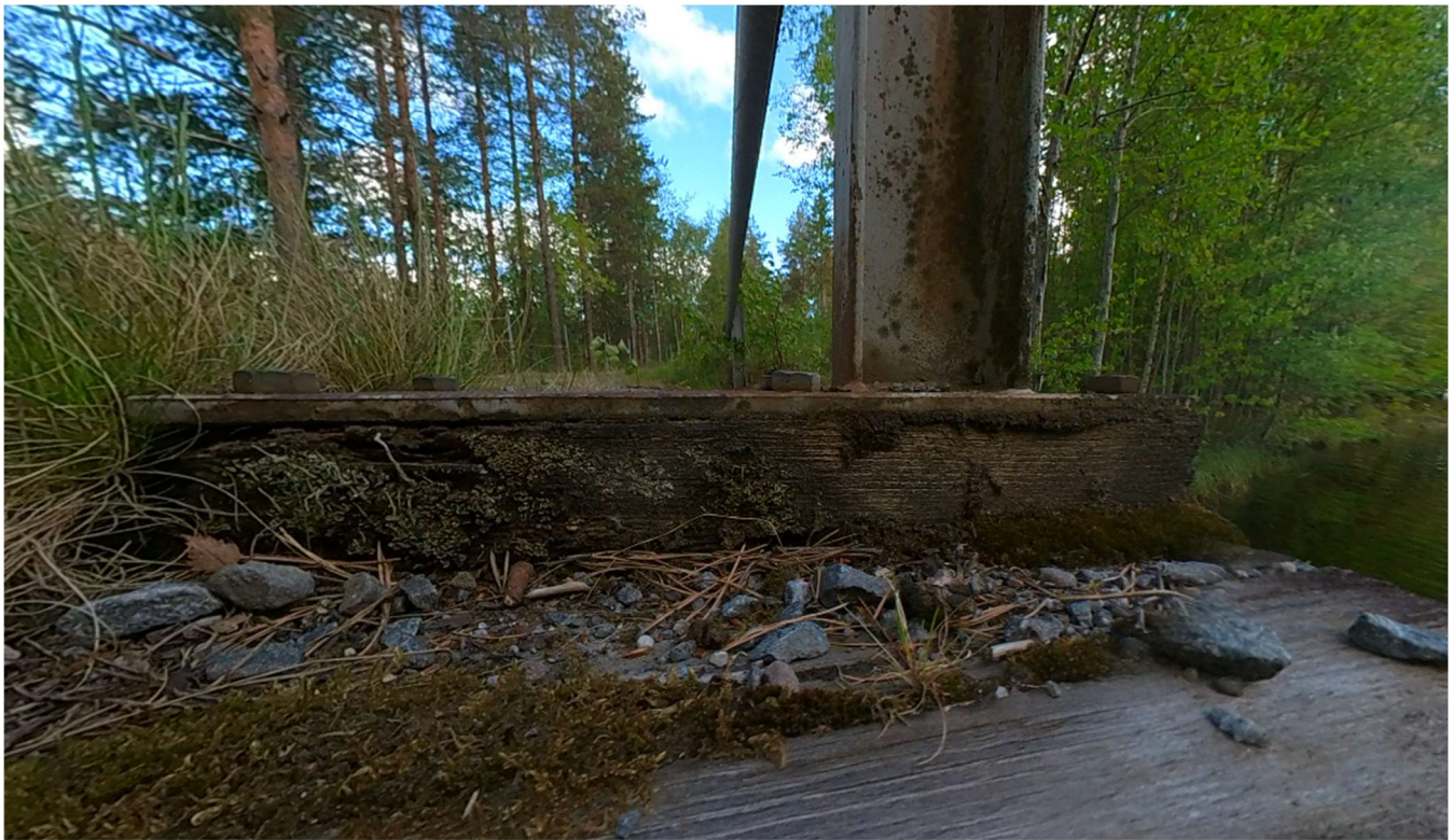
Kuva 14. Kaiteen kiinnitys sillankanteen on lahonnut.
