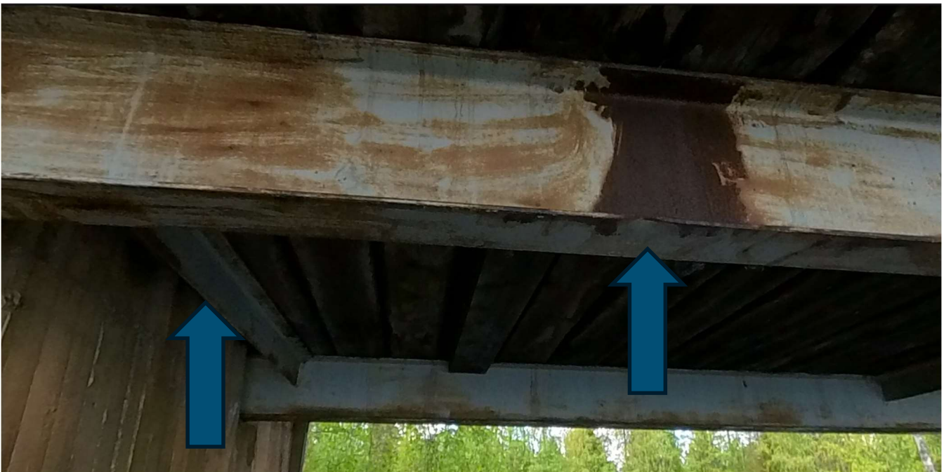
Kuva 8. Palkkien sivuttaistuenta ja vaurio alalaipassa.
