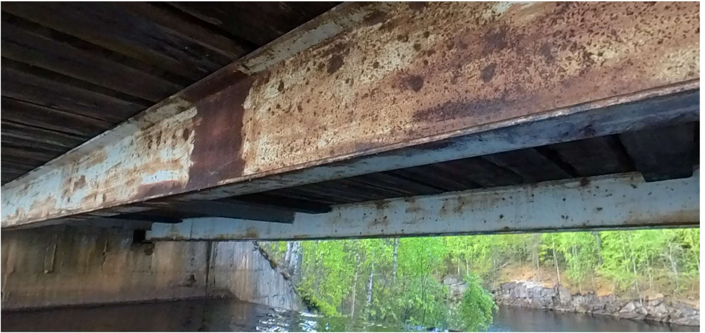
Kuva 9. Ruostetta tuen kaksi puoleisessa päässä.
